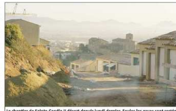
Le chantier de Sainte-Candie II désert depuis lundi dernier. Seules les grues sont restées en place. (Photo Ch. Chavignaud)
